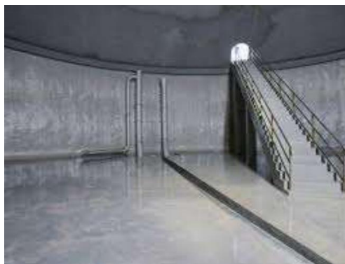
nádrže na pitnú vodu
