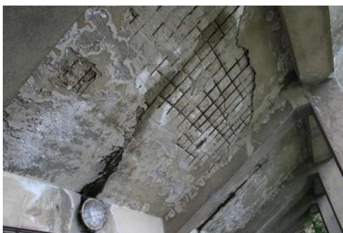
Obr. 8 Odpadaná krycí vrstva vlivem karbonatace a koroze výztuže
