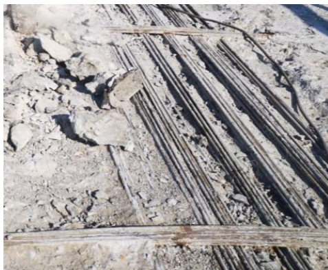
Obr. Korózia predpínacích drôtov v žľabe s rozpadom a degradáciou zálievky
