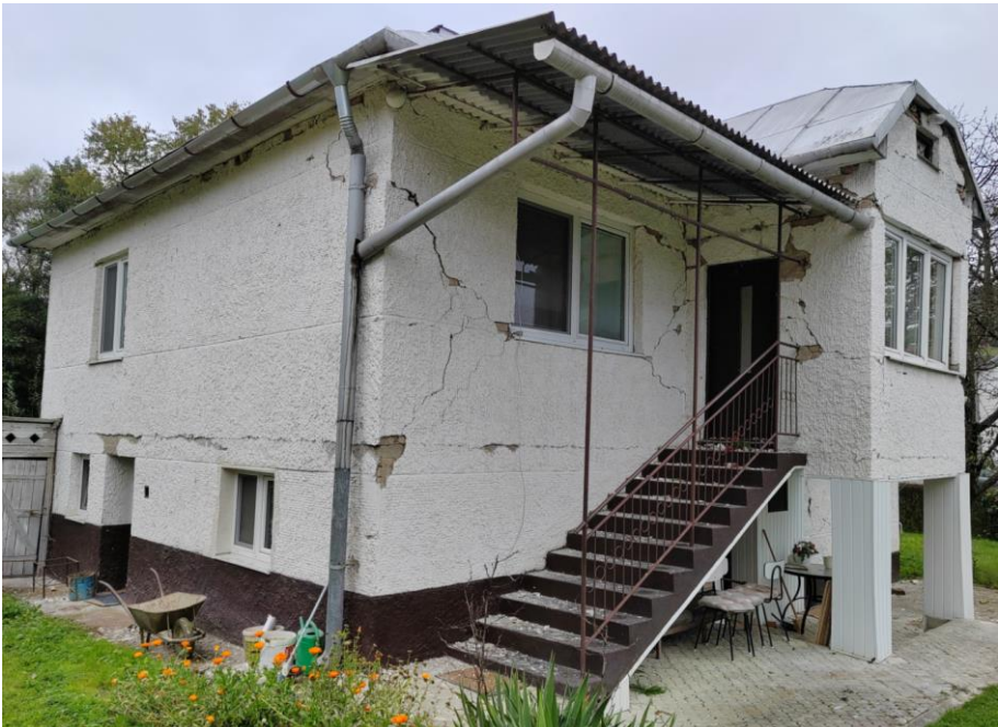
Obr. 5 Trhliny v nosných konštrukciách [Zdroj: SKSI]
