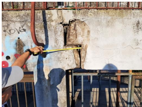
Obr. 7 Detail uložení vloženého pole, porušená konzola
