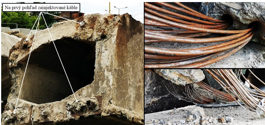
Obr. 1: Podvod s injektážou – aj napriek výskytu injektážnej malty v okolí odvodu v kotevných kuželíkoch sú káblové kanáliky kompletne nezainjektované (prefabrikát KA).
