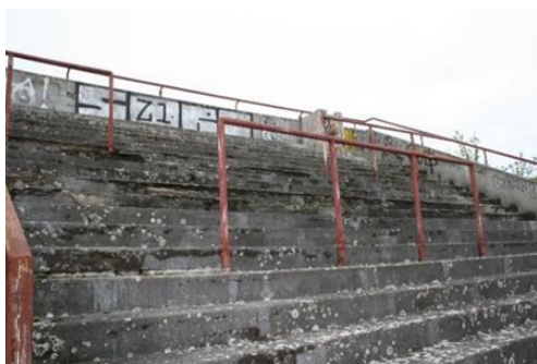
Obr. 4 Pohled na horní tribunu – koroze betonu stupňů
