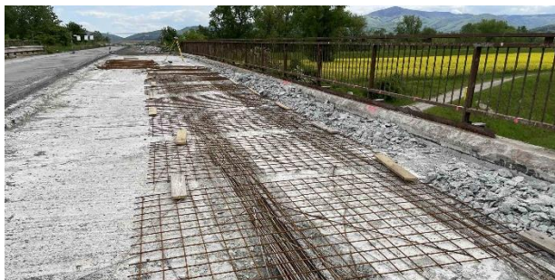
Obr. 2 – Pohľad na poškodenú predpínaciu výstuž
