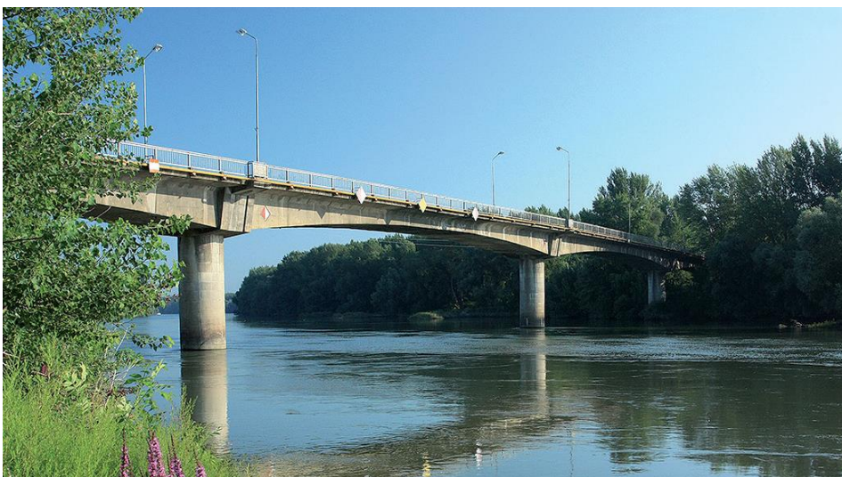
Obr. Most cez Váh v Kolárove v prevádzke od roku 1965, dĺžky 256 m, rozpätia polí 35,1+3x61,6+35,1m, jednokomorový prierez výšky 1,5-3,11 m.
