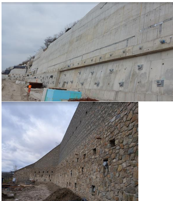
Obr.5 – Pohľad na západnú časť OM1 (možno vidieť nosníky s 5 lanovými kotvami, nosníky s 19 lanovými kotvami, tyče WR 47 osadené pred líc múru, vylamováký pre kvetináče, odvodňovacie otvory fí 70mm, v pozadí geodrenážna fólia medzi torkrétom a žb. stenou)
