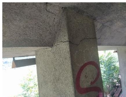
Obr. 5 Trhlina v hlavě sloupu
