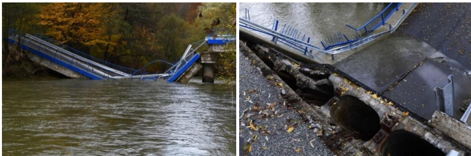
Obr. 1: Zrútenie mosta z prefabrikovaných nosníkov I-62 [3]
