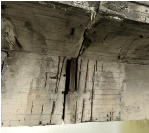
Obr. Poruchy Kĺb - Oceľová kyvná stienka
