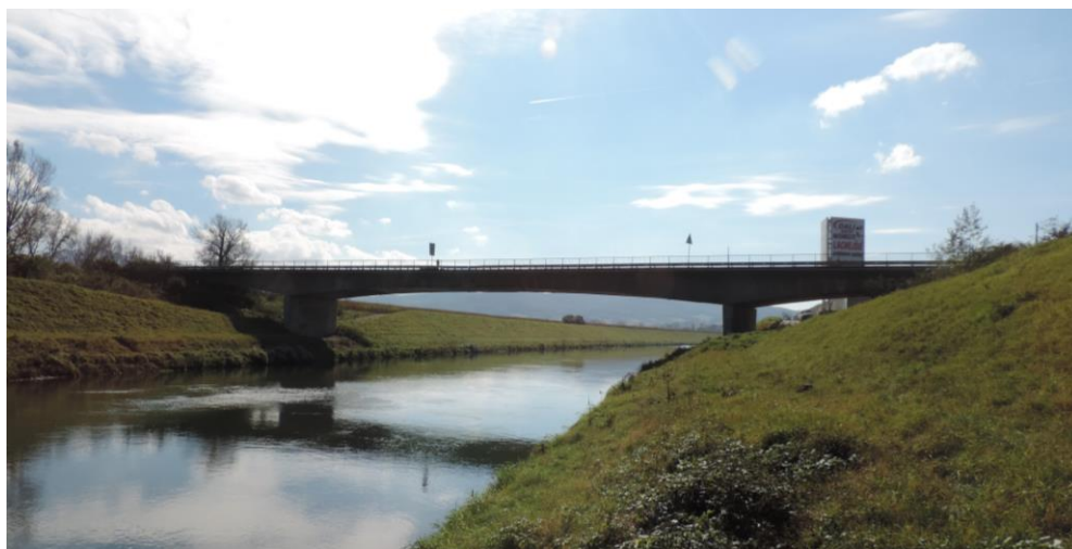
Obr. Most nad Biskupickým kanálom vo Veľkých Bierovciach v prevádzke od roku 1965, dĺžky 114 m, rozpätia polí 23,0+61,2+23,0 m, dvojkomorový priezrez výšky 1,5-3,2 m. Uloženie nosnej konštrukcie na piliere vrubovými kĺbmi, v mieste opôr kyvné stojky.
