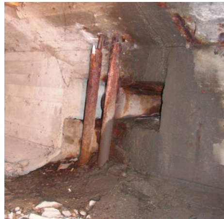
Obr. Poruchy Kĺb - Oceľové ložíská
