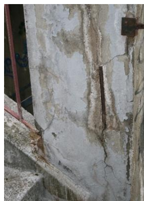
Obr. 9 Pata sloupu, odtržená přízdívka, obnažená podélná výztuž, zjevně bez třmíneků
