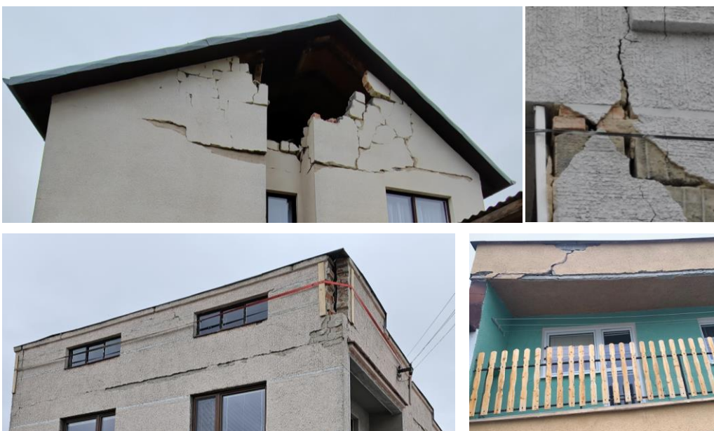
Obr. 8 Poškodenia štítových striech a atík [Zdroj: SKSI]
