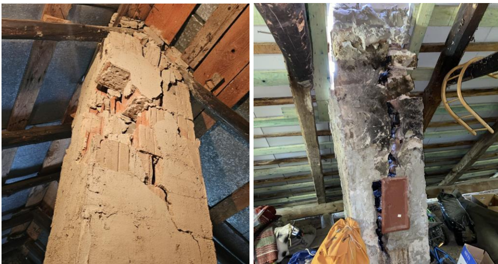
Obr. 7 Poškodenia komínov [Zdroj: SKSI]
